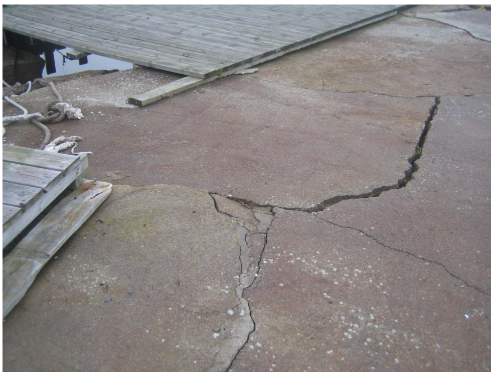
Bild 10. Sprickor i utkanten av fyllningen intill Tubberöd 1:252. Vy åt väster.
